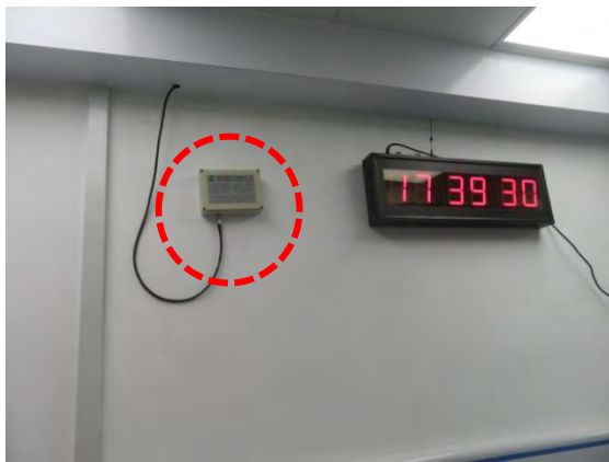
图 3-15 机房内固定式辐射监测仪
