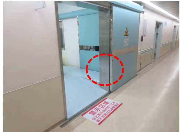
图 3-6 病人出入机房防护门红外防夹人装置
